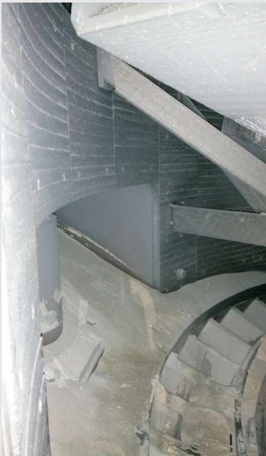
Wewnętrzne opancerzenie młyna pionowego The internal armaments vertical mill
